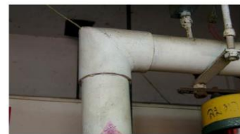
รูปที่ 2-3.19 การต่อท่อเมนหักฉาก 90° ที่ไม่เหมาะสม
